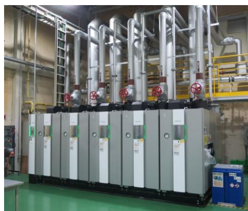
貫流ボイラー
